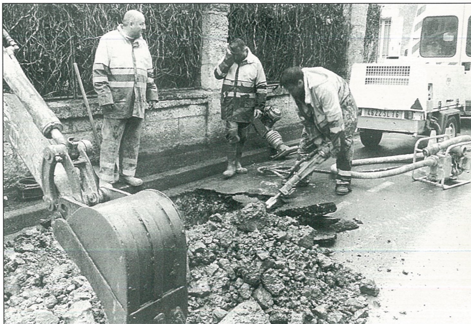
Fuite d'eau rue de la Boème, il a fallu trancher.
