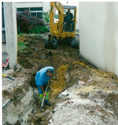
Une fois de plus, Franck Troussicot a répondu à la pelle, pour réparer le réseau du chauffage de l'école
