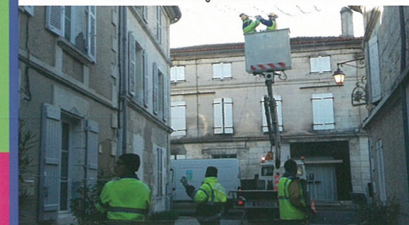
Pose des illuminations de Noël avec la nacelle prêtée par la commune de La Couronne
